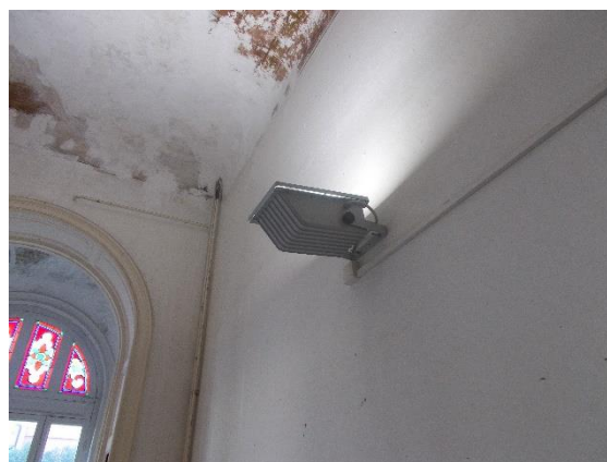
Figura 4.12 - Particolare dei corpi illuminanti
