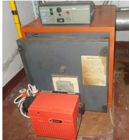
Figura 8.4 – Particolare della caldaia
