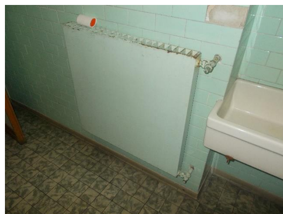
Figura 4.6 – Particolare dei radiatori
