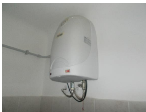
Figura 4.10 - Particolare di un boiler elettrico per la produzione di acqua calda sanitaria
